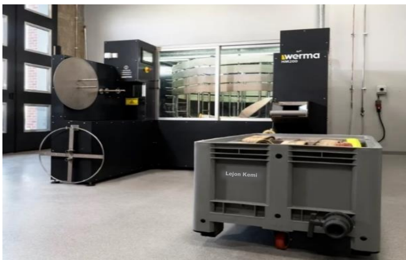
Slangevaskemaskin fra Werma AB og et bløtleggingskar for brannslanger på en brannstasjon i Sverige.
